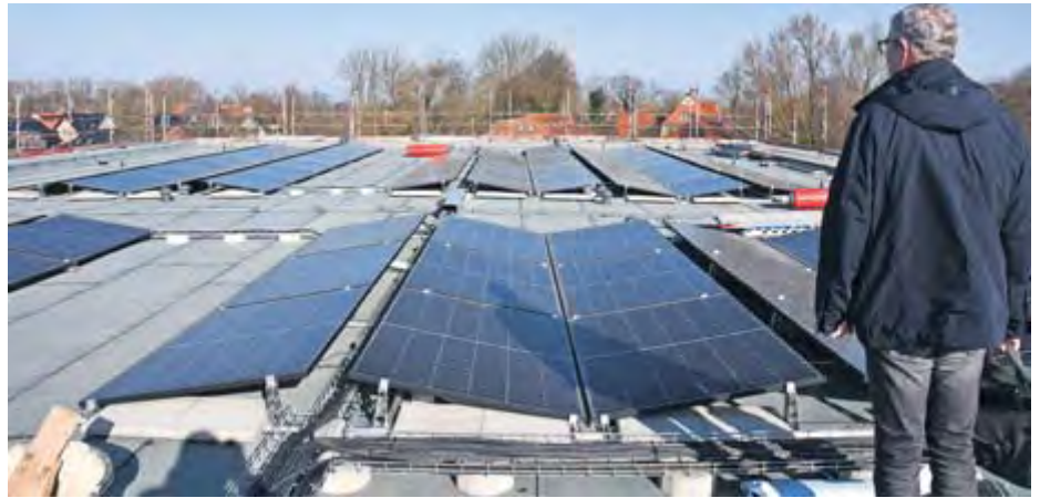
Das Flachdach des Seniorenheimes am Medembogen bezieht den größten Teil seines Stroms aus der Photovoltaik-Anlage. Fotos: Egbert Schröder
